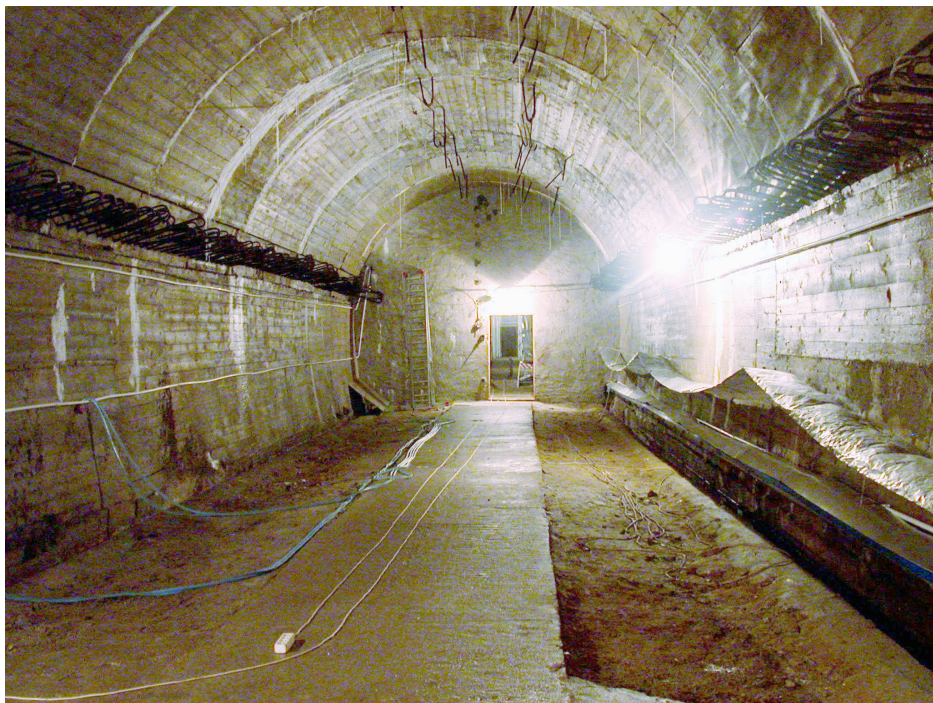
Klinometr hydrostatyczny 0102 (65 m długości) poprowadzony po prawej ścianie korytarza
